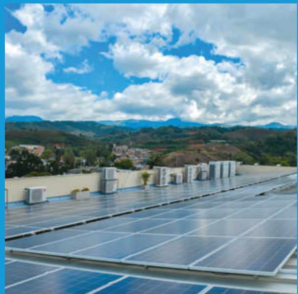
Proyecto solar CDM Transformadores
